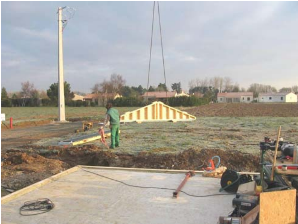
Proximité de ligne électrique
